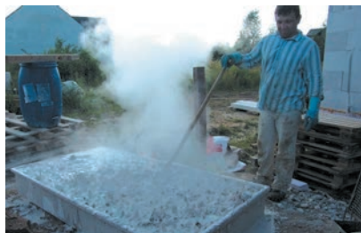
Мал. 18.1. Гасіння негашеного вапна водою супроводжується виділенням значної кількості теплоти
